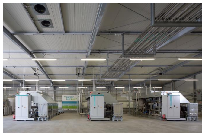
ドイツのEnergiepark Mainz は「power-to-hydrogen」のコンセプトを模索するための共同プロジェクト 写真出典: シーメンズ・エナジー
